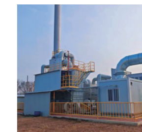
天津拠点のVOC処理装置
