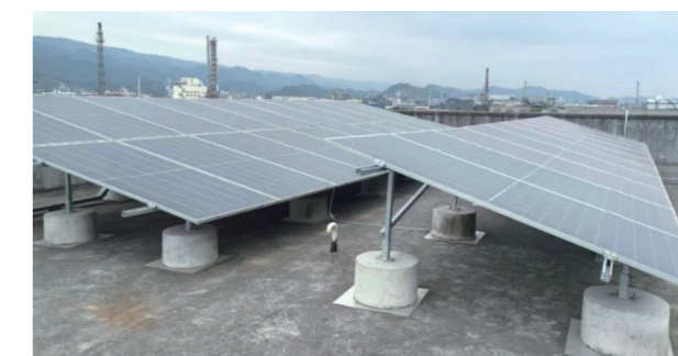
重慶拠点で2025年11月より稼働を開始した太陽光発電
