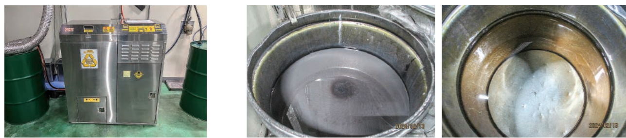
溶剤蒸留装置 廃溶剤 蒸留後洗浄液
